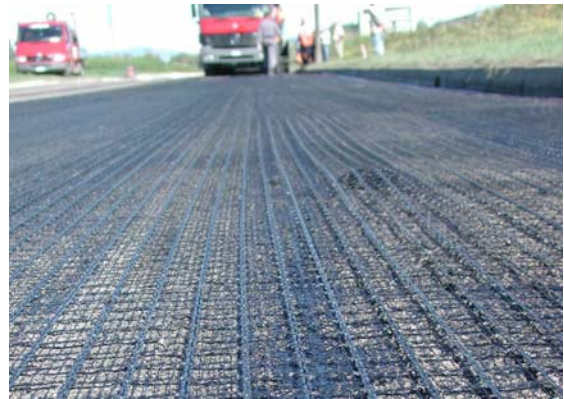
Fig. 7 - Due operai sono in grado di stendere un intero rotolo di Geogriglia ARTER® GTS A in pochi minuti
